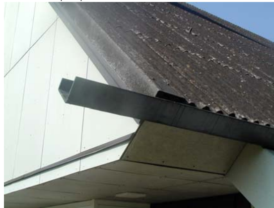
Lastre ondulate in fibrocemento con amianto, foto: JMF/SLE, IST
