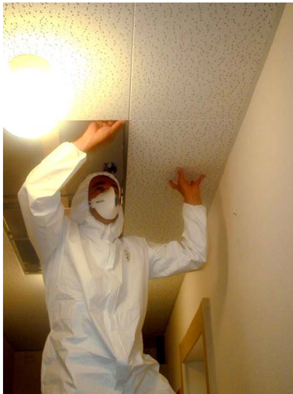
Pannello da soffitto sganciato (pannello fonoassorbente), foto: JMF/SLE, IST
