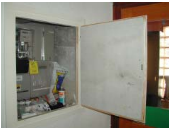
Scatola dei fusibili con lastra antincendio all'amianto sulla porta interna, foto: JMF/SLE, IST
