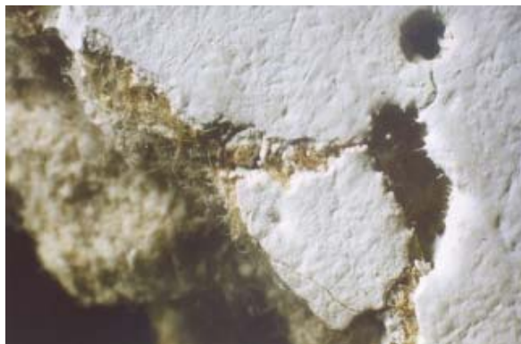
Ingrandimento di un pannello fonoassorbente con foro tipico e fibre (lana minerale e amianto), foto: SA
