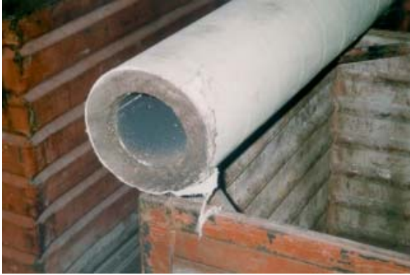
Isolazione di tubazioni contenente amianto, foto: MS, IST
