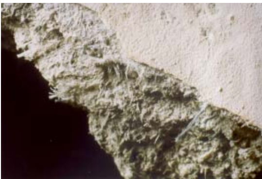
Lastra spezzata in fibrocemento con amianto, con ciuffi di fibre d'amianto visibili a occhio nudo, foto: SA
