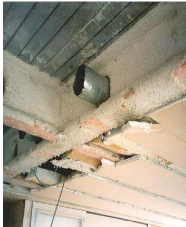
Floccato d'amianto in una struttura portante in metallo, foto: JMF/SLE, IST
